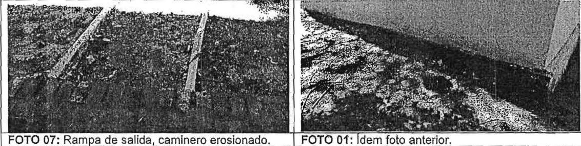
FOTO 07: Rampa de salida, caminero erosionado.
