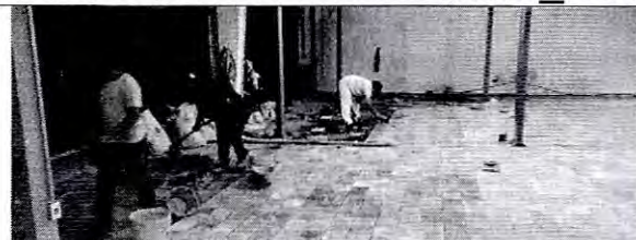
Foto 05: Obras en la Hemeroteca. Asentamiento de piso.
