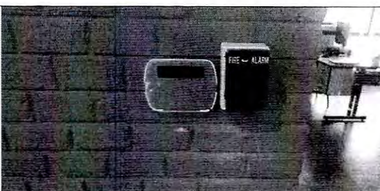
Foto 08: Control central de humo-calor.
