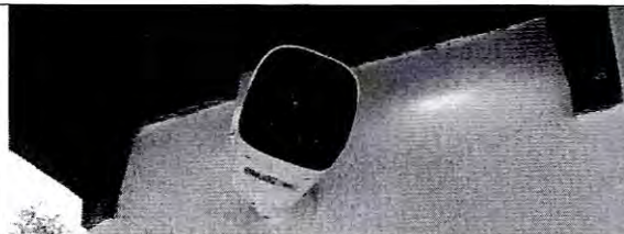
Foto 17: Museo Casa y Oratorio Cabañas. Cámaras de control.
